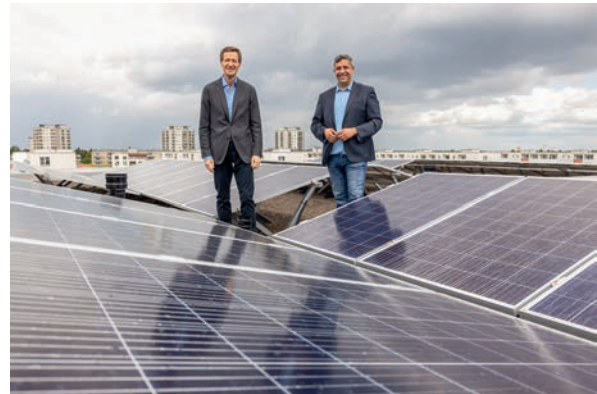
WIE 207 | Kiezstrom-PV-Anlage der BEA
