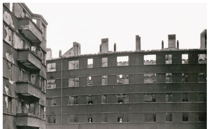
Die WIE 310 mit schweren Kriegsschäden © Archiv Charlotte
