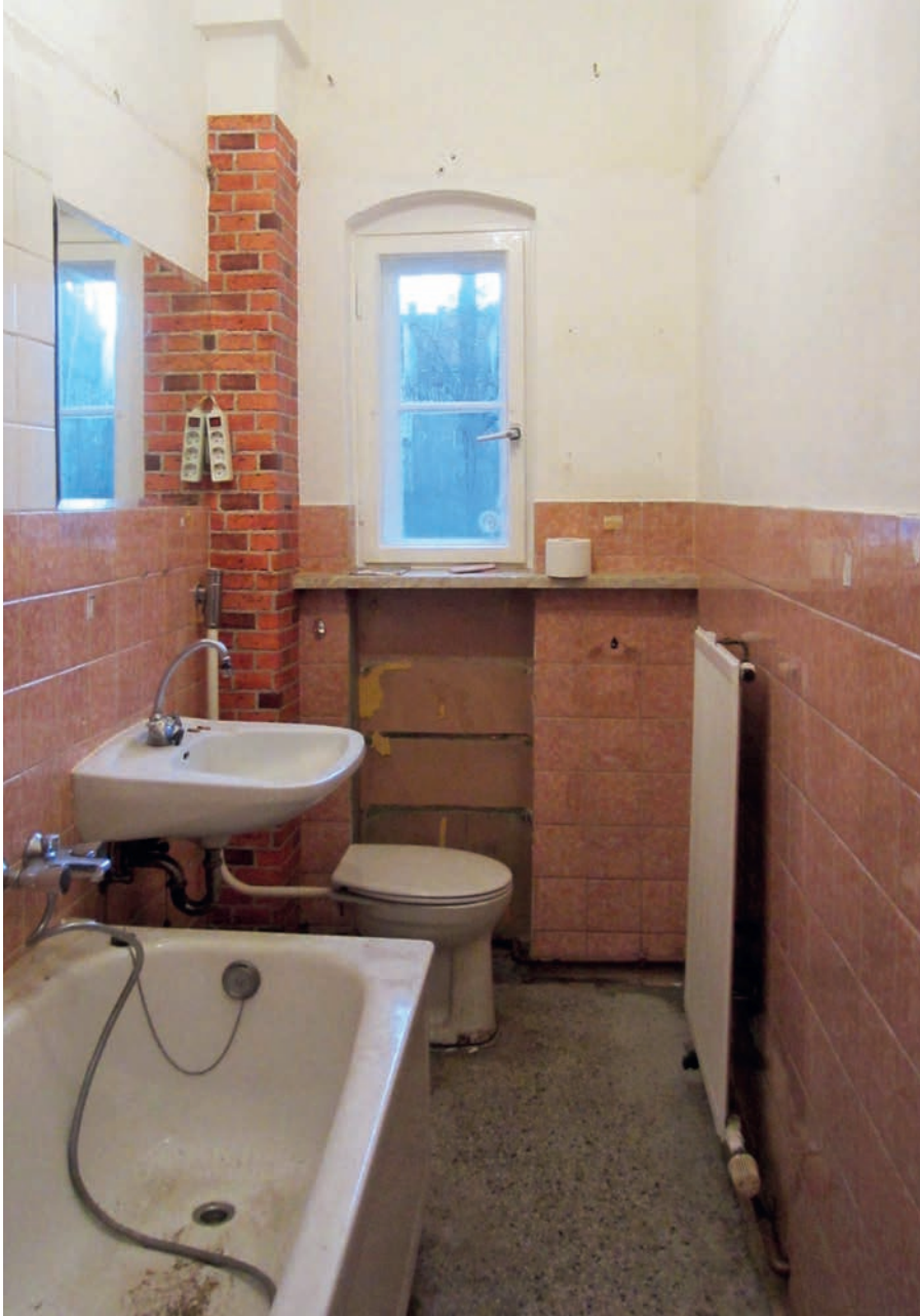
Abb. 3: Modernisierungswürdiges Badezimmer in Reinickendorf © Dirk Winkler/Charlotte
